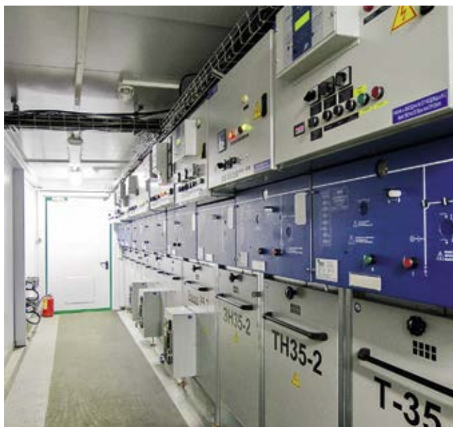
КРУМ 35 кВ с однорядным расположением шкафов
